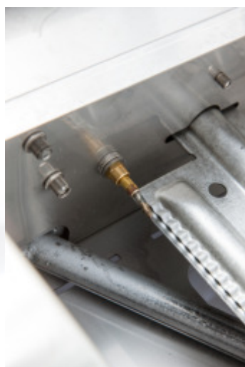
Termocoppia di sicurezza che blocca l'uscita del gas se un colpo di vento spegne la fiamma
